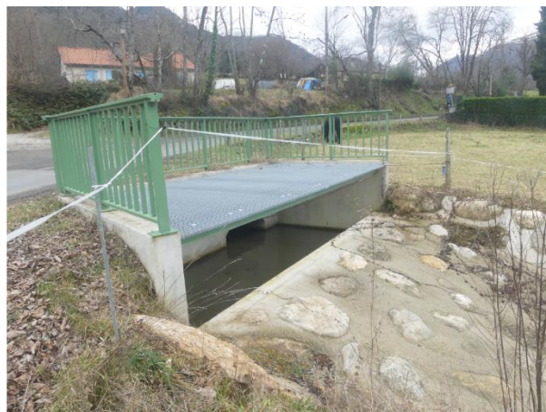
Ouvrage hydraulique de surverse en bordure de la RD23
